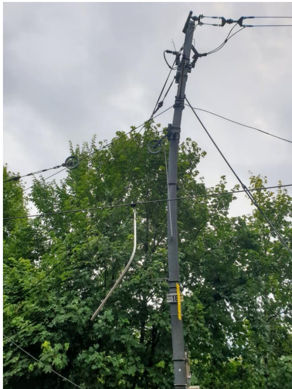
Das Sturmtief Bernd beschädigte unter anderem 20 Fahrleitungsmasten.
