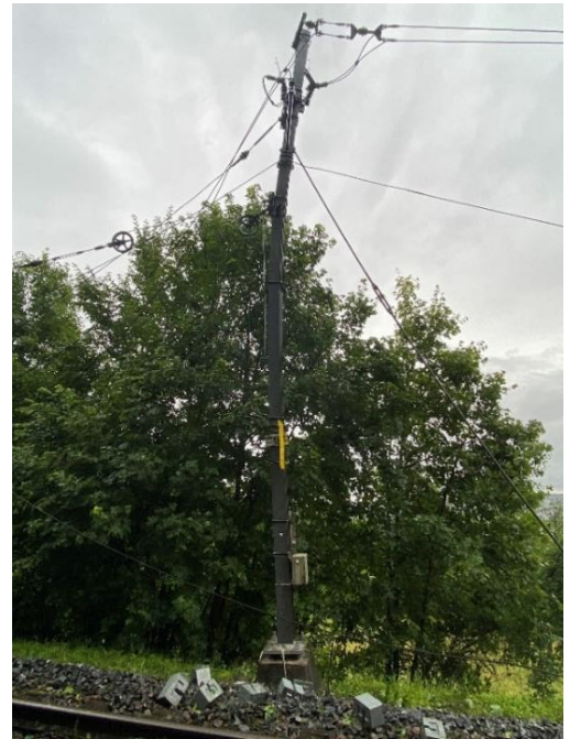
Geknickter Fahrleistungsmast bei Berghof.
